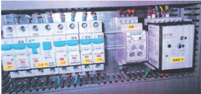
Slika 4. Automatski osigurači u ormanu LVVFD [3]
