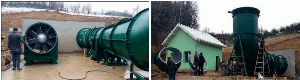
Slika 1. Ventilatorsko postrojenje s ventilatorom AVD-650-90kW Begiči [3]
