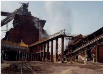
Slika 1. Prikaz bazena za granulisanu trosku sa instaliranim kranovima iznad bazena
